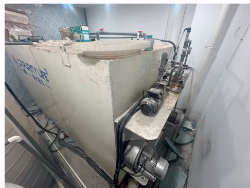
Sewage treatment system of 3D Medicines 思路迪醫藥污水處理系統
